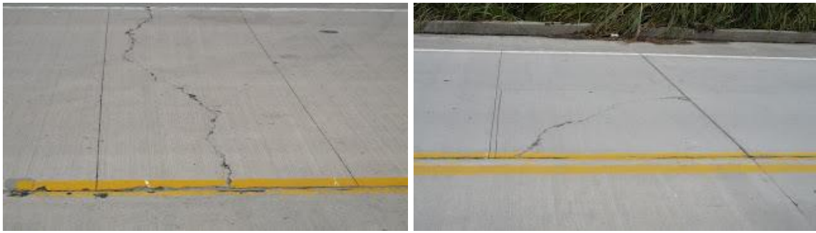
Figura 1-9: Falla por faulting y fisuración en esquina en pavimento rígido
